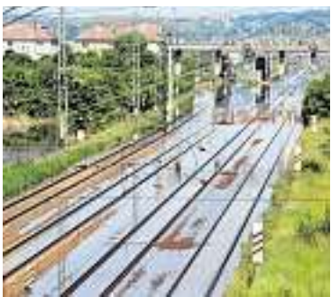
Unter Wasser: Die Elbeflut hat zu massiven Beeinträchtigungen des Bahnverkehrs geführt. FOTO: DPA
